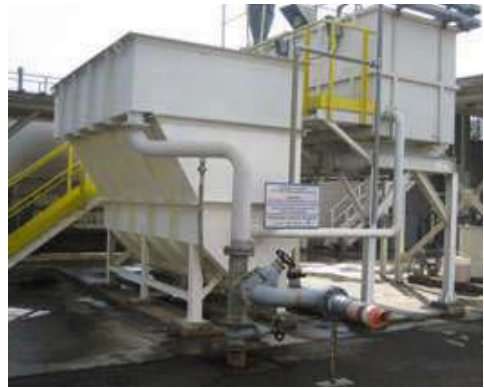
Foto 8 - Vasca a pacchi lamellari e vasche di condizionamento chimico-fisico
