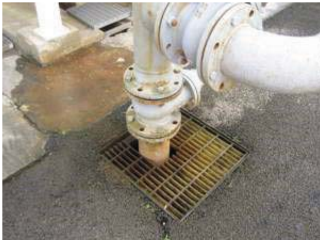
Foto 9 - Scarico finale del refluo depurato
