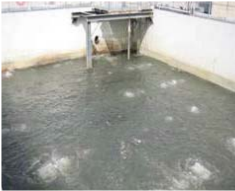
Foto 7 - Vasca di omogeneizzazione
