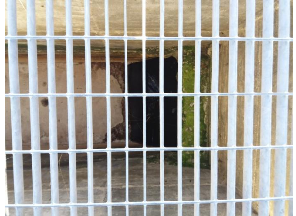
Figura 14. Pozzetto di scarico dell'impianto. Più' in basso il canale di scarico e di by-pass.
