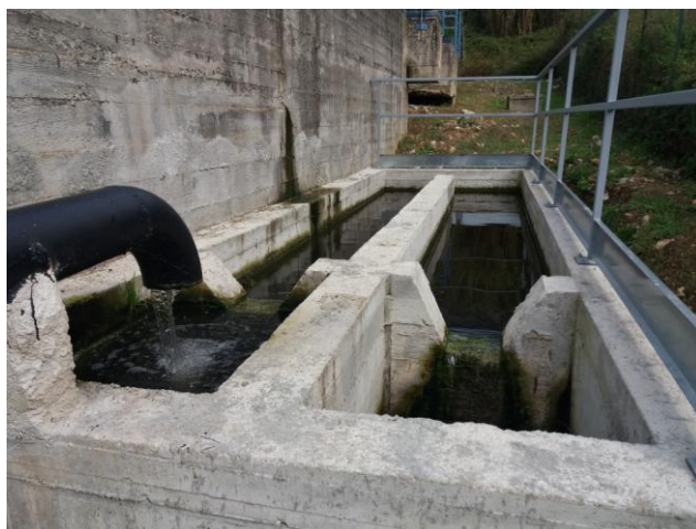
Vasca di disinfezione
