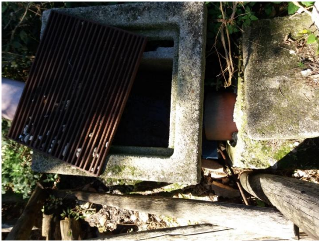
Ultimo pozzetto della rete fognaria prima dell'ingresso all'impianto con sfioro (non chiuso). La griglia che dovrebbe essere posizionata sul flusso dei liquami è adagiata sul pozzetto.
