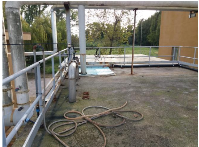
Dettaglio vasca di stripping
