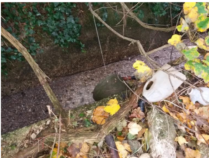
Scarico del depuratore
