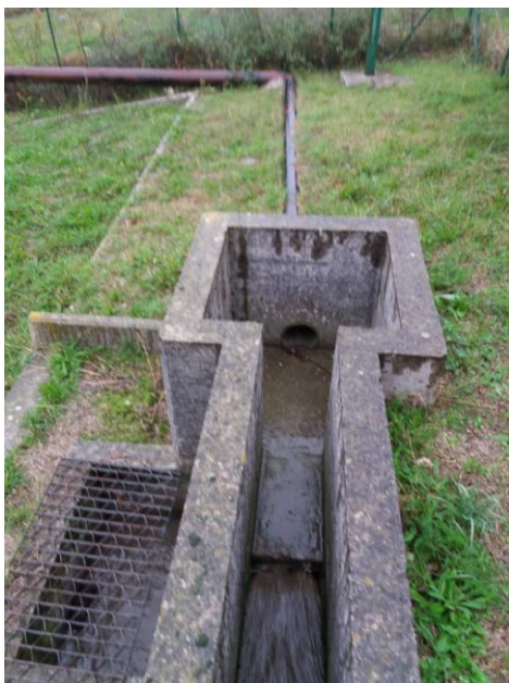
A sinistra il passaggio all'ossidazione. In fondo il by-pass pioggia, alla disinfezione
