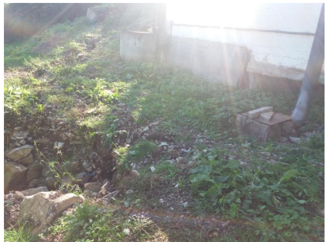
Pozzetto fiscale. Nel terreno è visibile l'erosione generata dall'acqua
