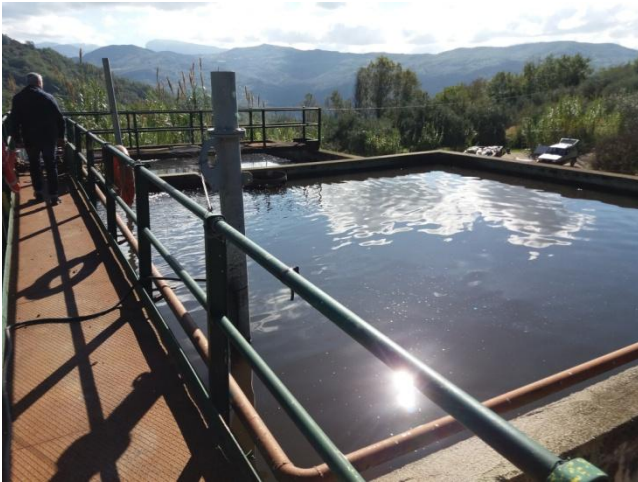
Davanti la vasca di ossidazione, in fondo la vasca di sedimentazione.
