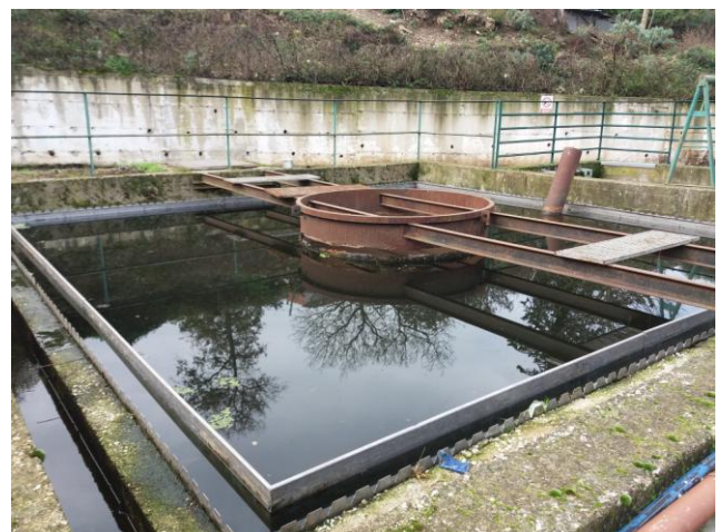
Vasca di sedimentazione
