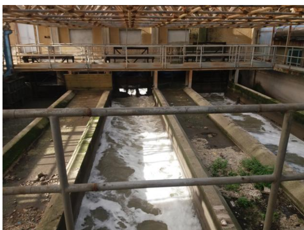
Canali, passaggio liquami dalla grigliatura grossolana alla grigliatura fine
