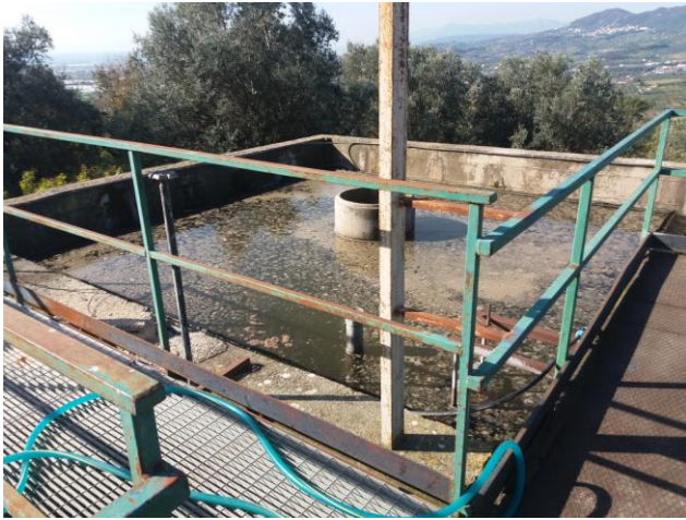
Vasca di sedimentazione
