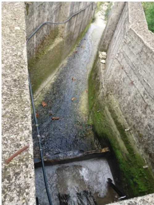
Ingresso reflui e sfioro
