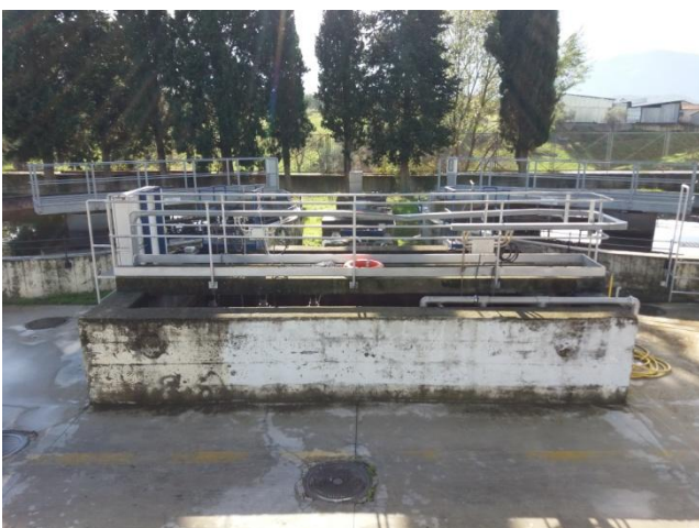
Pozzetto ricircolo fanghi
