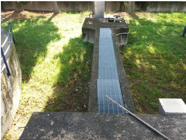
Uscita dei reflui alla condotta snam
