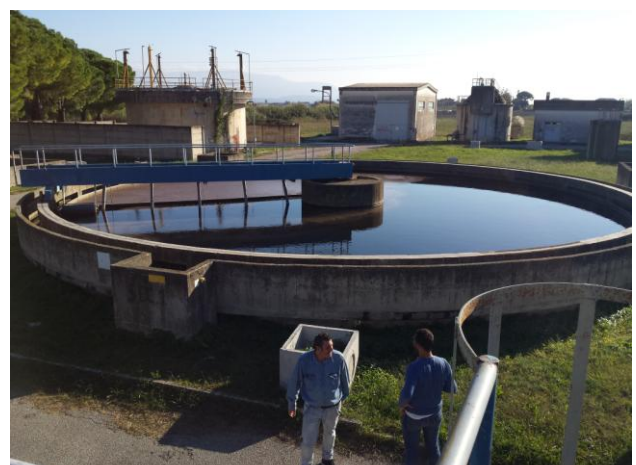
Vasca di sedimentazione primaria sinistra idraulica
