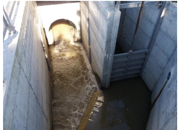
Figura 2. Sulla destra la paratia di by-pass dei liquami provenienti dalla rete fognaria ed inviati (a sinistra) al fiume Tusciano. Dopo la paratia doveva essere installata la grigliatura automatica, mentre prima del canale di sinistra la grigliatura manuale.
