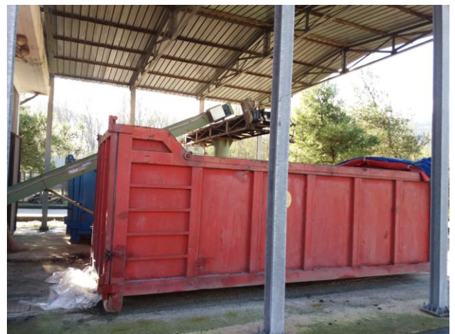
Scarico fanghi dalla nastropressa
