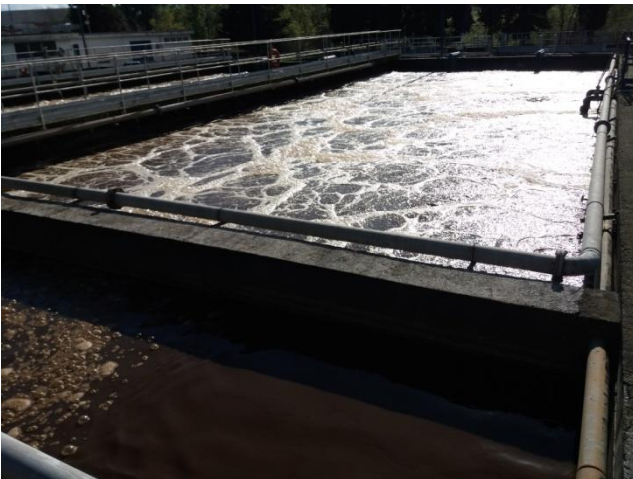
La vasca di digestione aerobica dei fanghi.
