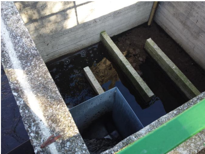
Dettaglio della vasca di raccolta dei reflui prima dello scarico. Per aumentare i tempi di contatto la disinfezione è avviata all'uscita della sedimentazione.
