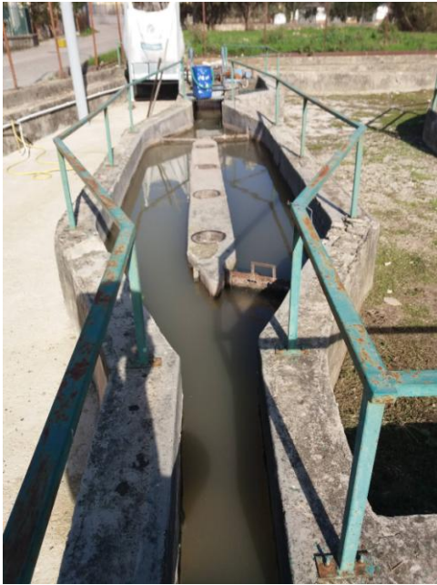
Dal fondo in sequenza: ingresso reflui, grigliatura automatica e manuale, canale di dissabbiatura
