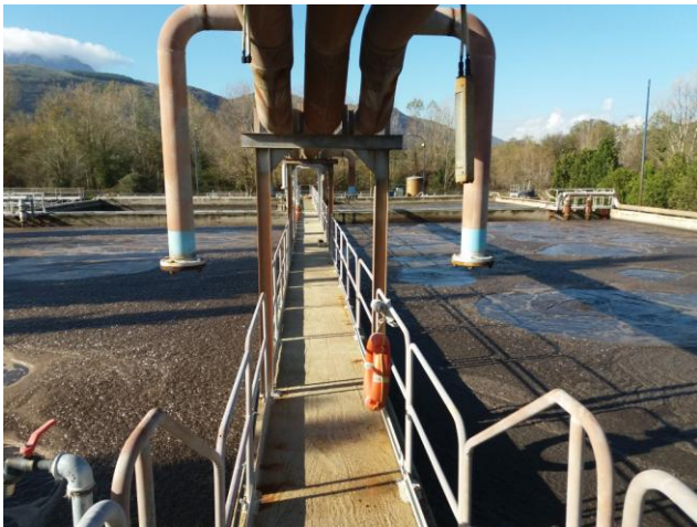
Davanti le vasche di ossidazione. In fondo le vasche di digestione aerobica dei fanghi
