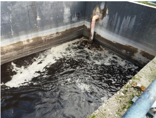
Vasca di accumulo rifiuti liquidi
