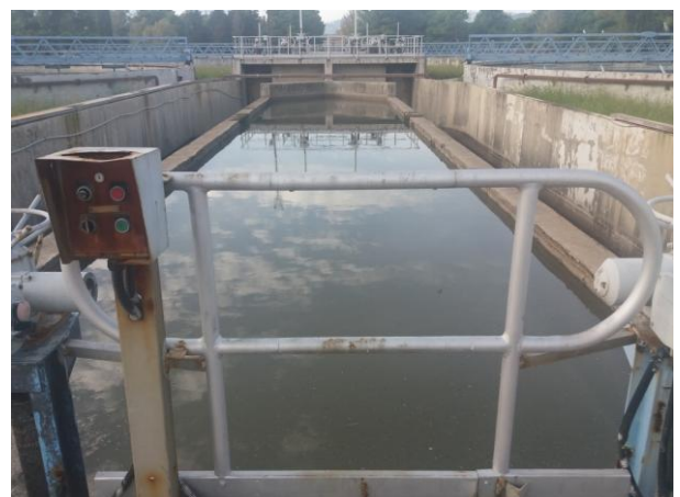
Dettaglio vasca alla fine della sedimentazione primaria. Vista da s-e. I canali ai lati fungono da sfioro
