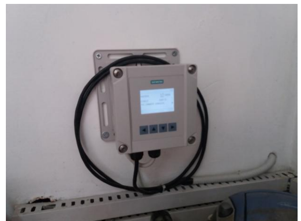
Misuratore di portata nel locale tecnico
