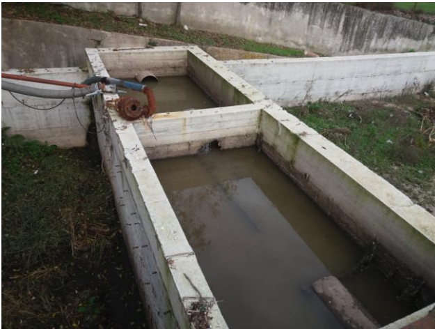
Pozzetto entrata reflui zona bassa e dissabbiatura
