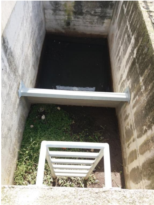
Ingresso liquami e grigliatura grossolana
