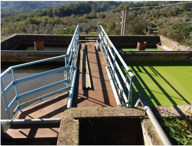
Panoramica impianto. Davanti le due vasche di ossidazione, in fondo le 2 vasche di sedimentazione. La linea di destra (verde in superficie, non è funzionante).
