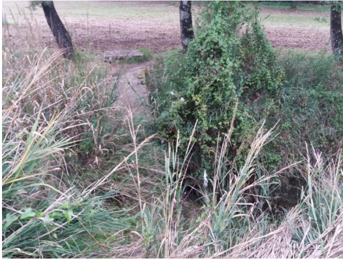
Ultimo pozzetto della rete fognaria prima dell'ingresso all'impianto con sfioro
