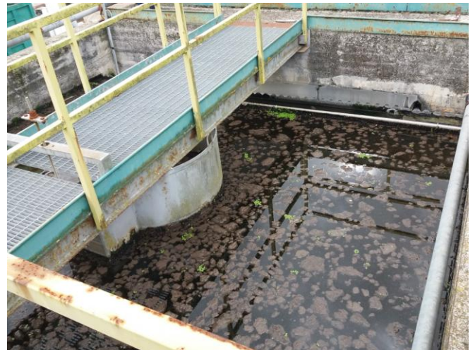
Vasca di sedimentazione
