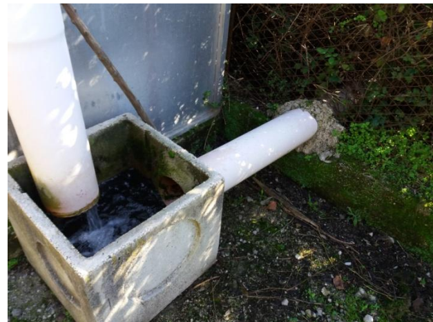
Pozzetto di carico nel Torrente Varicella - Coppi
