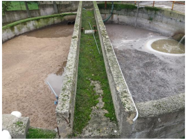
Vasca di ossidazione sinistra. Vasca di denitrificazione a destra
