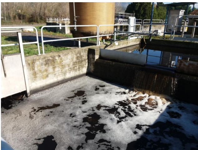
Vasca di disinfezione. A sinistra l'uscita alla condotta snam
