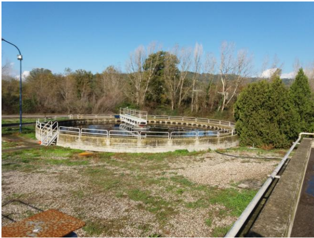
Vasca di sedimentazione secondaria
