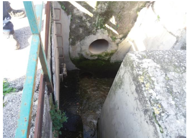
Tubazione di scarico al corpo ricettore
