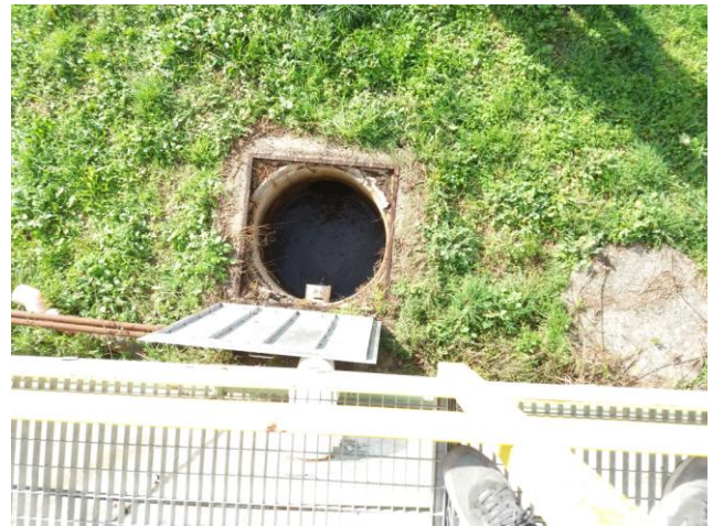
Pozzetto uscita acque trattate
