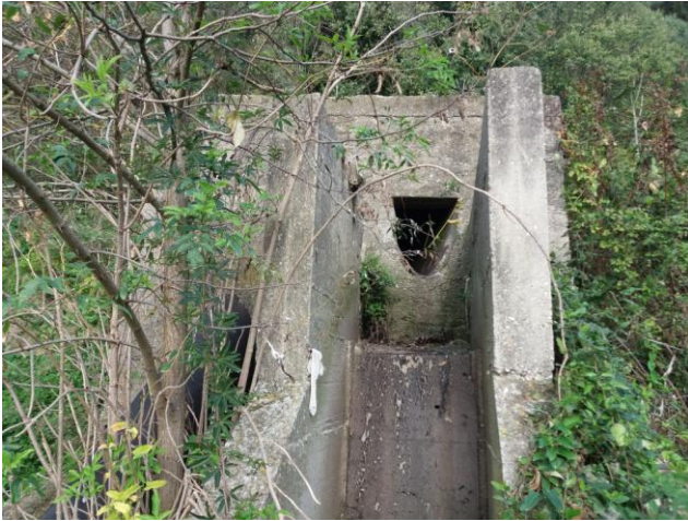
Ultimo pozzetto della rete fognaria con sfioro
