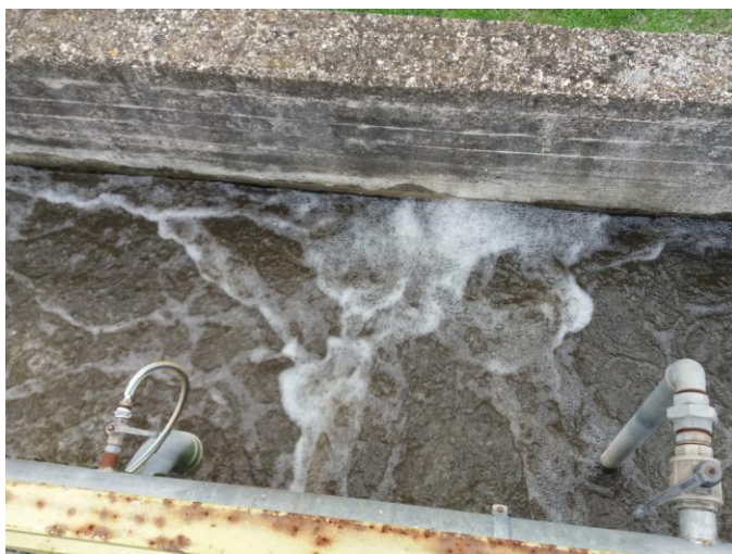
Vasca di stabilizzazione fanghi di supero (non funzionante, solo passaggio)
