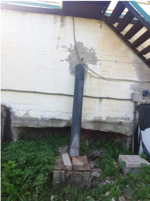
Pozzetto fiscale. Dietro al pozzetto è visibile l'erosione del manufatto generata dall'acqua
