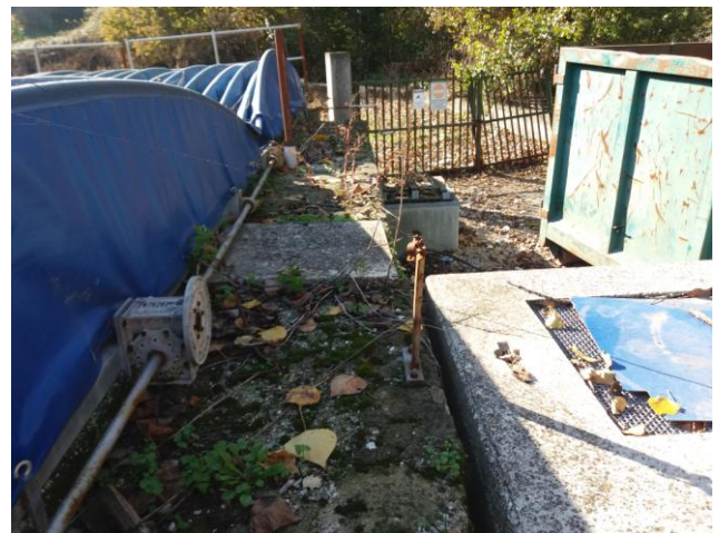
Pozzetti acqua drenaggio
