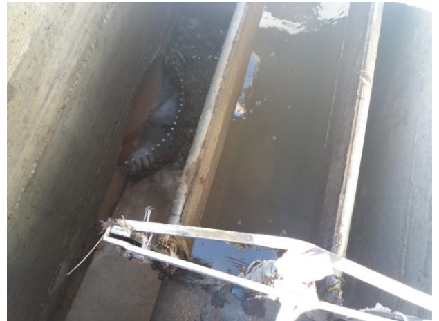
Sfioro dell'ultimo pozzetto della rete fognaria prima dell'immisione dei reflui al depuratore
