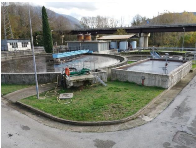
Davanti sedimentatore primario lato sinistro e vasca di ispessimento stabilizzazione. Alle spalle il sedimentatore secondario non funzionante
