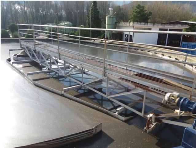
Vasca di sedimentazione primaria
