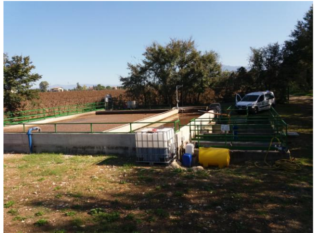
Sulla destra la vasca di raccolta dei reflui prima dello scarico, sulla sinistra la vasca di predenitrificazione e ancora piu' a sinistra la vasca di ossidazione.
