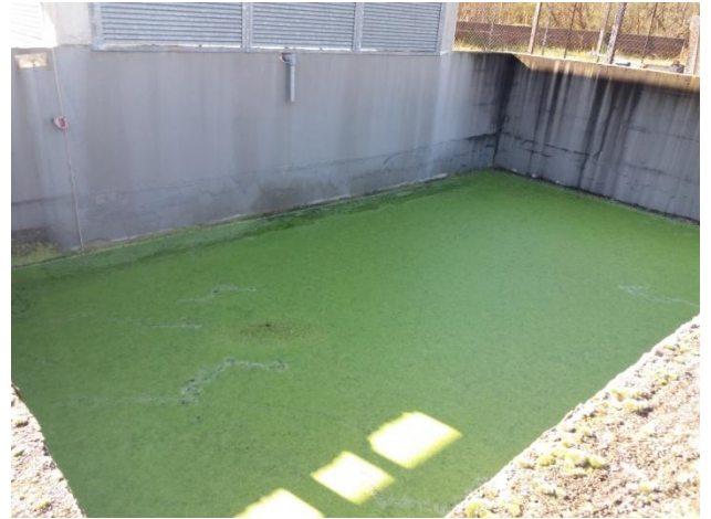
Bacino di contro lavaggio filtri
