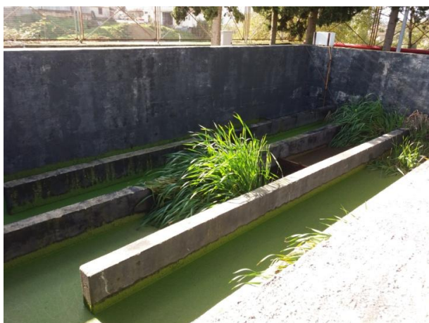
Vasca di disinfezione
