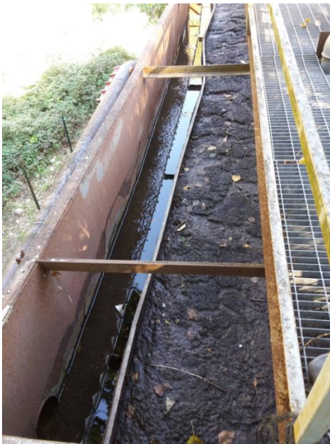
Vasca di sedimentazione
