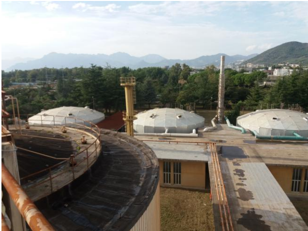
In primo piano sulla sinistra il digestore anaerobico. In secondo piano, le tre cupole sono gli ispessitori
