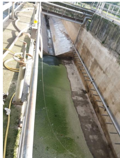
Dettaglio del canale di dissabbiatura/preareazione, disoleazione in manutenzione
