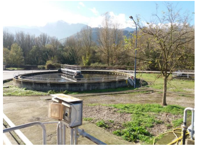
Vasca di sedimentazione secondaria
