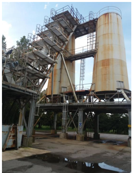
A destra i silos di stoccaggio dei fanghi disidratati
