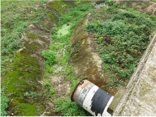
Scarico acque seconda pioggia
