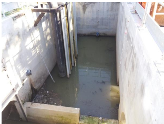
Figura 3. Vasca di sollevamento liquami in ingresso. Rilanciati alla dissabbiatura e disoleatura
