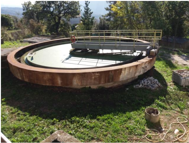
Vasca di sedimentazione
