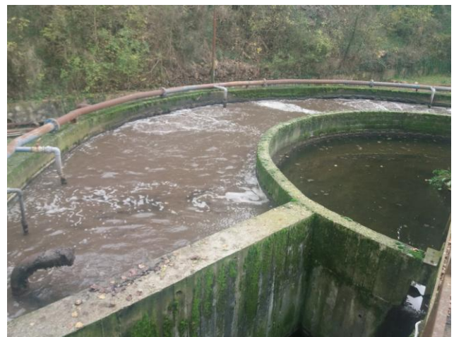
Vasca di ossidazione dettaglio lato sinistro
