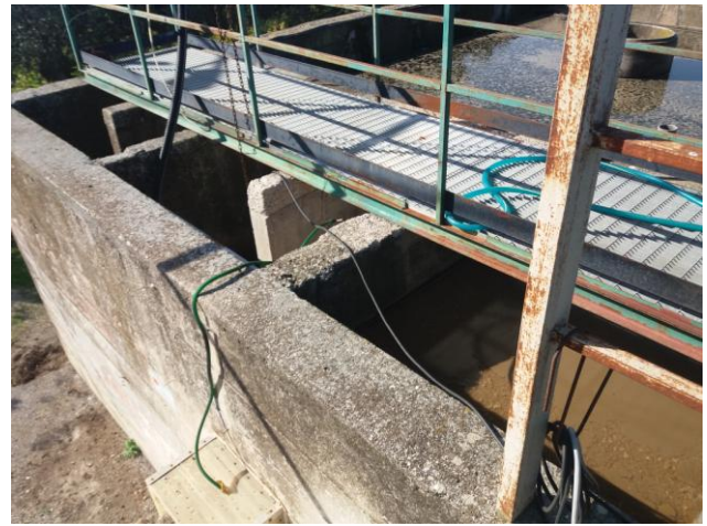
In fondo la disinfezione, al lato il pozzetto di ricircolo fanghi
