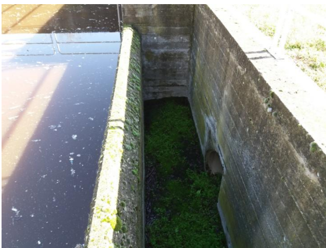
Vasca di disinfezione. Uscita alla condotta per la filtrazione
