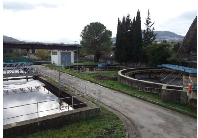
Davanti sedimentatore primario lato destro non funzionante. Alle spalle il sedimentatore secondario
