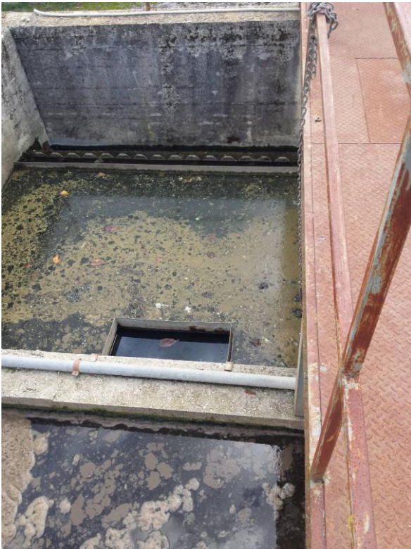
Vasca di sedimentazione e disinfezione
