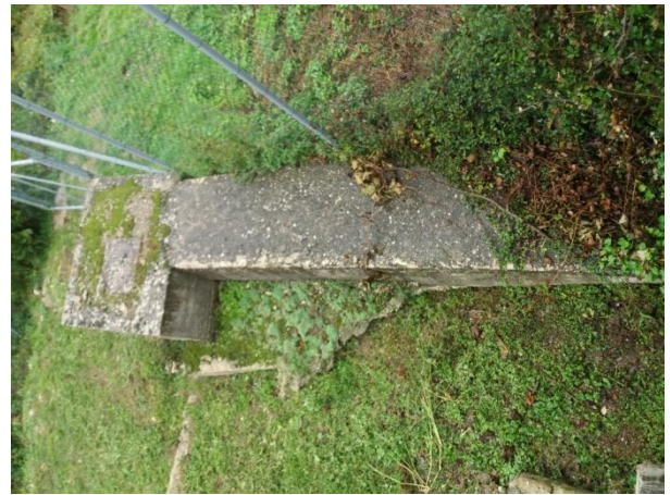
Sfioro dell'ultimo pozzetto della rete fognaria.
