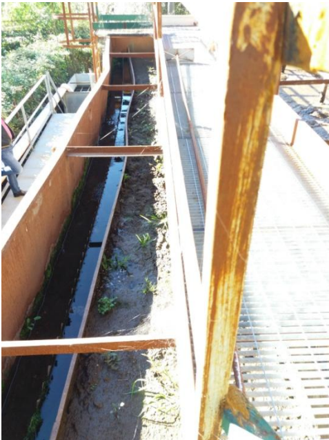
Vasca di sedimentazione
