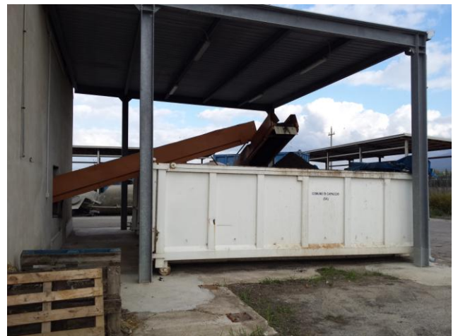
Fanghi in uscita dalle centrifughe
