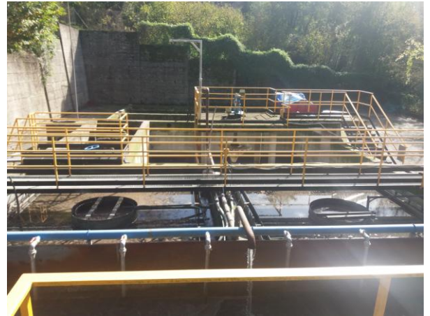
Vasche di sedimentazione
