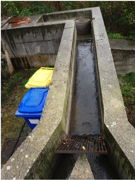
Canale Di ingresso dei reflui. In fondo è visibile il tubo di sfioro, davanti la grigliatura manuale.
