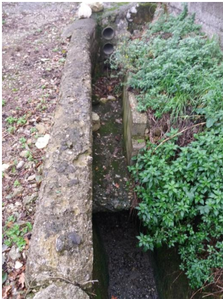
Ultimo pozzetto della rete fognaria, prima del recapito al depuratore con sfioro
