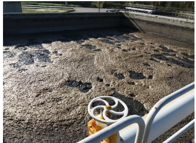
La vasca di digestione aerobica dei fanghi, lato sinistro
