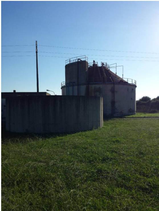
Digestore anaerobico 1° stadio
