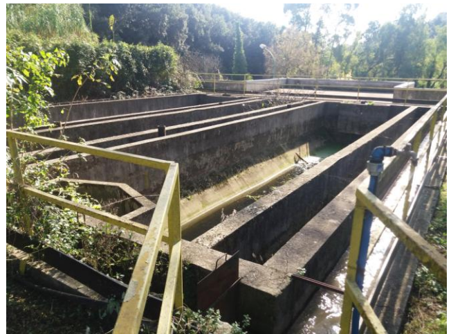
Dalla dissabbiatura, tramite il canale alla vasca di ossidazione
