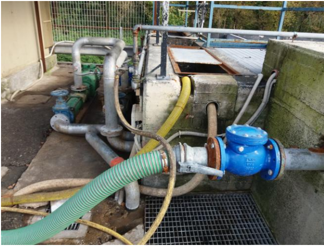
Ingresso rifiuti liquidi
