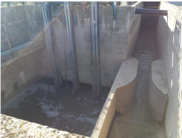
Vasca sollevamento liquami in ingresso
