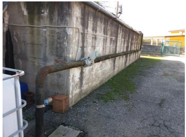
Misuratore di portata sulla mandata del sollevamento
