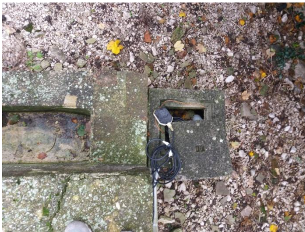
Pozzetto ricircolo acque drenate nei letti di essiccamento
