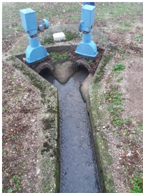
La saracinesca di sinistra è chiusa. A destra il passaggio alla vasca di ossidazione.
