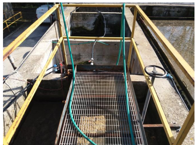
In fondo la disinfezione, davanti il pozzetto di ricircolo fanghi
