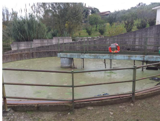
Vasca di sedimentazione
