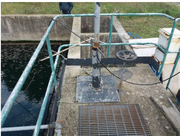
Pozzetto ricircolo fanghi adiacente alla vasca di sedimentazione
