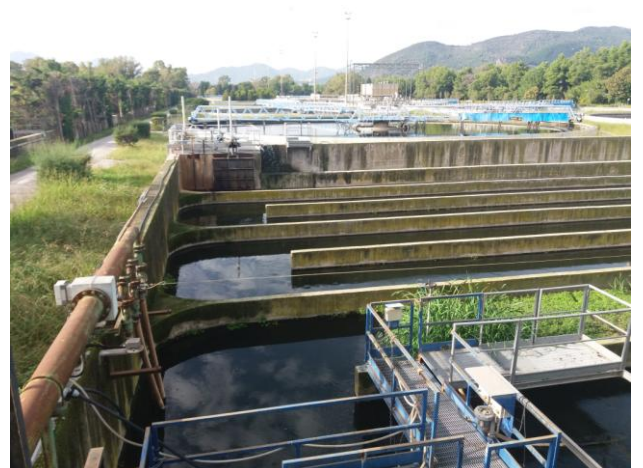
In primo piano la vasca di disinfezione, alle spalle la sedimentazione secondaria
