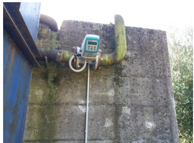
Misuratore di portata sulla mandata del sollevamento
