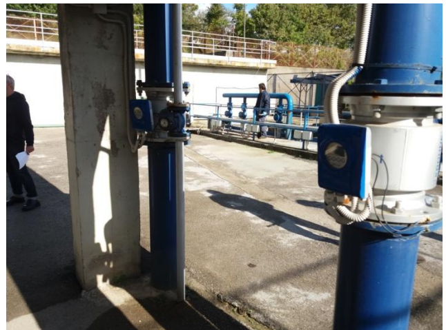
Sulle tubazioni sono installati i misuratori di portata dei reflui in ingresso (tubo grande a sinistra) delle acque di prima pioggia (tubo piccolo a sinistra) delle acque bianche a destra
