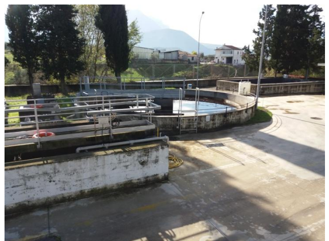
Vasca di sedimentazione secondaria
