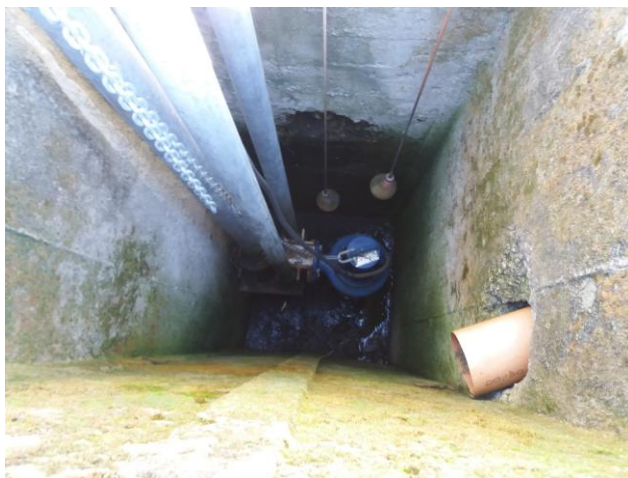
Pozzetto raccolta acque di drenaggio dei letti di essiccamento
