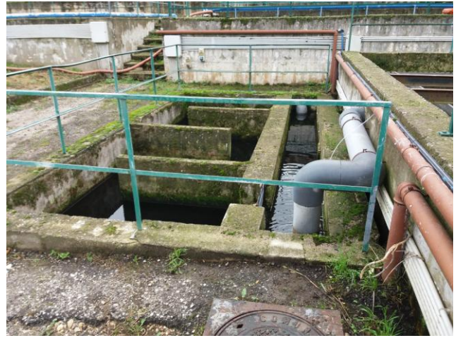
Disinfezione e pozzetto di uscita acque trattate
