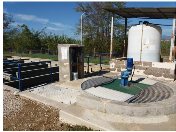
Figura 12. Vasca omogeneizzazione e clorazione.
