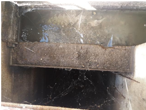
Pozzetto arrivo reflui
