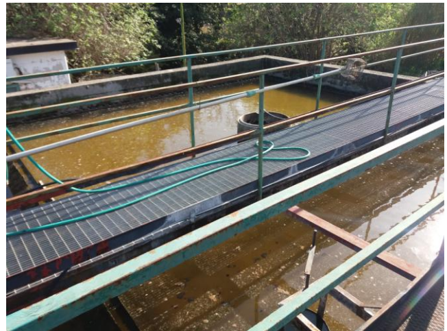
Vasca di sedimentazione
