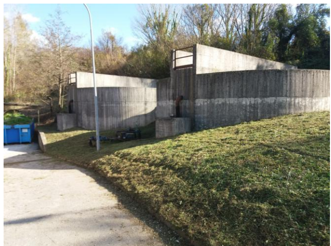
Ispessitori non funzionanti
