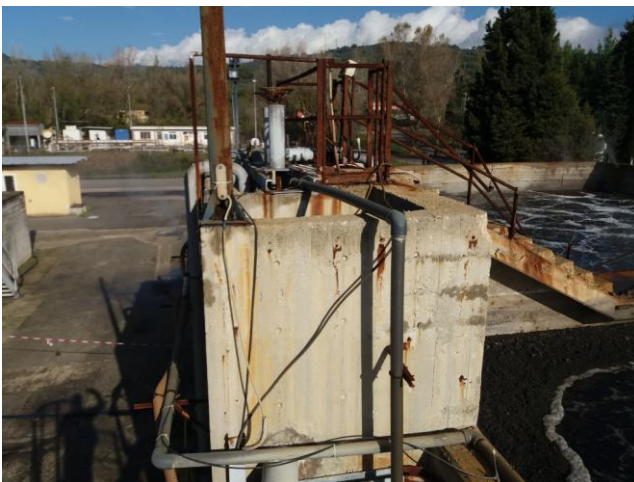
Pozzetto uscita bilanciamento
