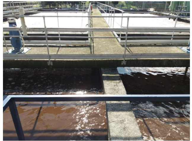
Davanti le vasche di denitrificazione. In fondo le vasche di ossidazione
