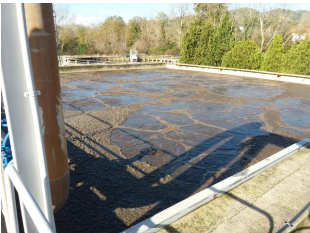
La vasca di digestione aerobica dei fanghi, lato destro
