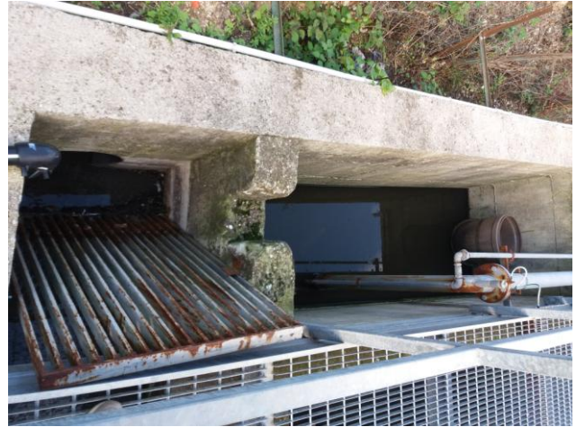
Ingresso liquami, a sinistra la grigliaura, a destra lo sfioro
