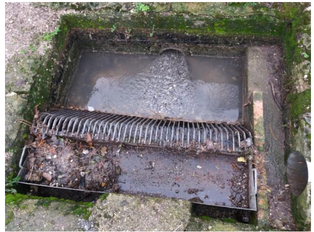
Ingresso dei reflui, grigliatura e sfioro
