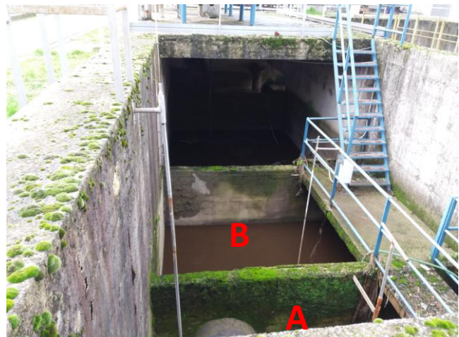
Vasca di disinfezione. Il setto A (attraversato dal tubo) è destinato alle acque di seconda pioggia. Il setto B raccoglie i reflui prima di recapitarli in condotta.
