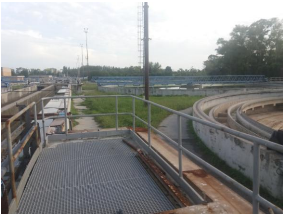
Panoramica lato destro sedimentazione primaria
