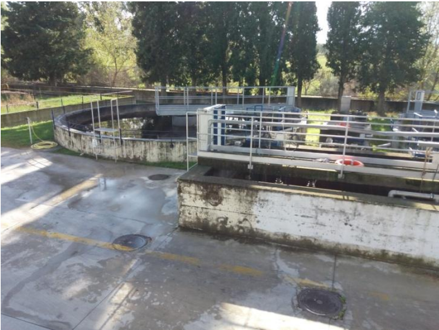
Vasca di sedimentazione secondaria
