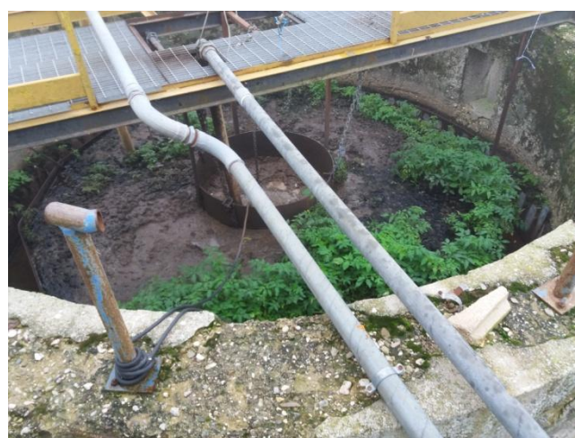
Vasca di sedimentazione
