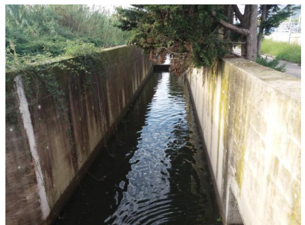
Canale in cui si riversano le acque sfiorate dopo la sedimentazione primaria
