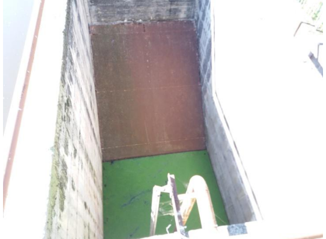
Pozzetto accumulo fanghi di supero adiacente alla vasca di sedimentazione, non funzionante
