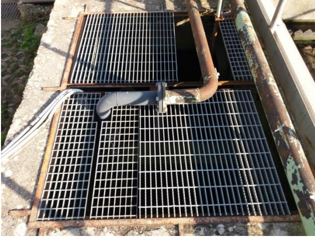
Pozzetto ricircolo fanghi
