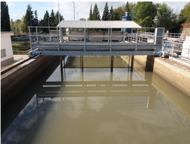
Il tubo di sinistra porta le acque bianche ad un canale e poi alla vasca di accumulo
