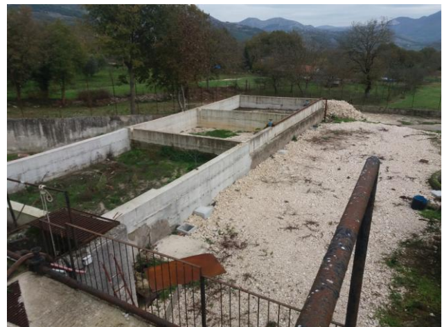
Pozzetto di uscita acque trattate
