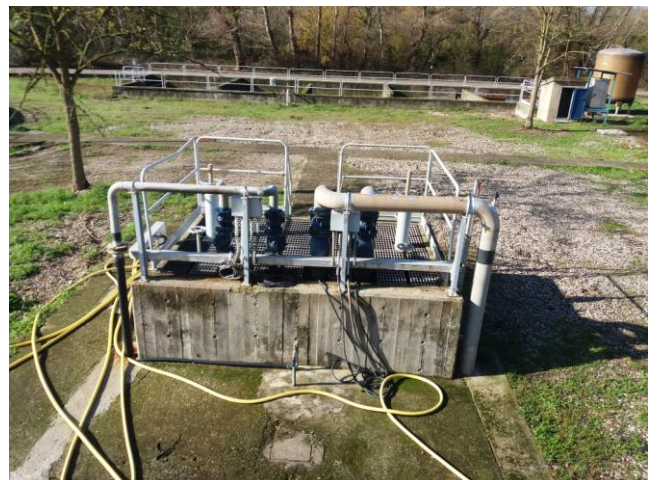
Pozzetto ricircolo fanghi
