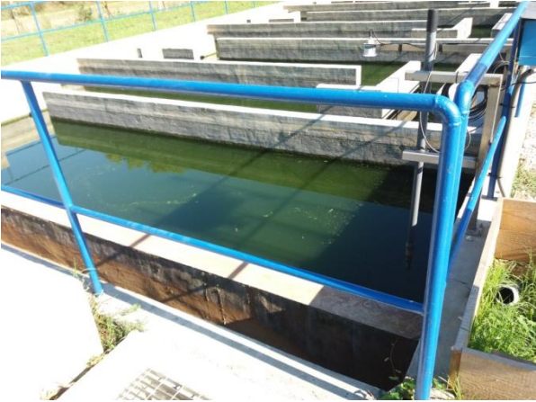
Figura 13. Vasca disinfezione. In alto a destra il misuratore di portata
