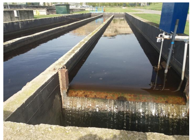
Vasca di disinfezione
