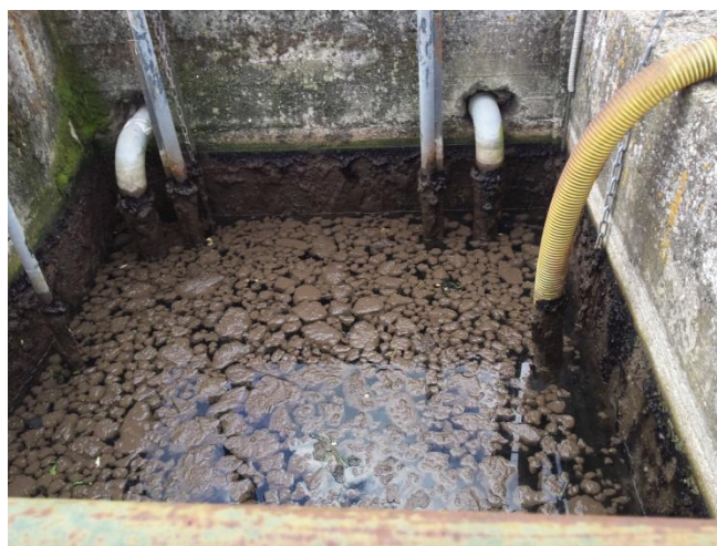
Pozzetto ricircolo fanghi adiacente alla vasca di sedimentazione
