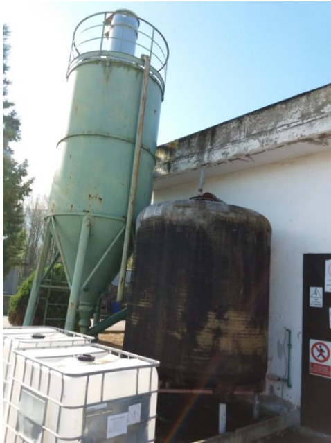
Silos calce per stabilizzazione fanghi
