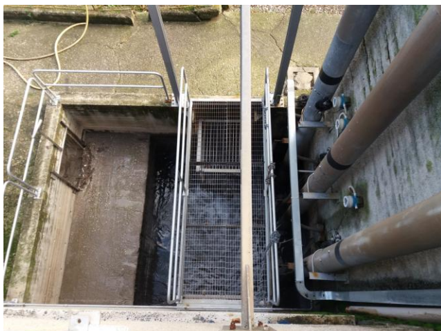
A sinistra ingresso reflui e grigliatura grossolana. Sollevamento ai trattamenti primari. Sulle tubazioni sono installati i misuratori di portata. A sx griglia di troppo pieno per condotta snam
