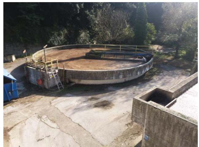
Vasca di sedimentazione
