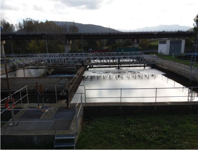
Le prime due vasche di sinistra e destra sono di denitrificazione. Le vasche successive sono di ossidazione
