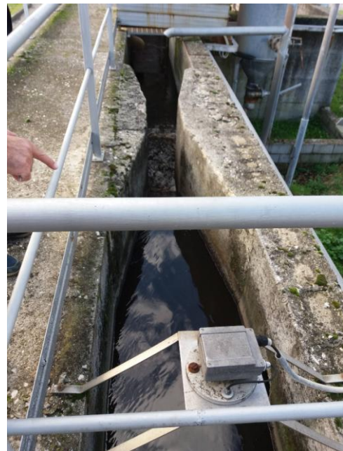
Misuratore di portata e venturimetro
