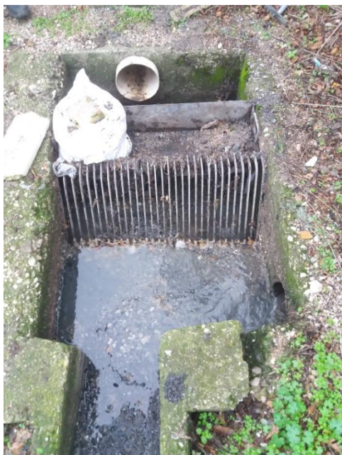
Ingresso reflui, dai due tubi, sfioro e grigliatura manuale
