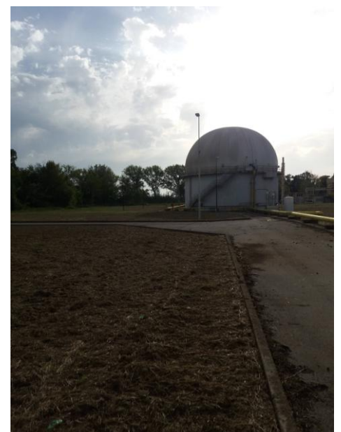
Alla sinistra della campana gascometrica la torcia di combustione dei gas dei digestori anaerobici
