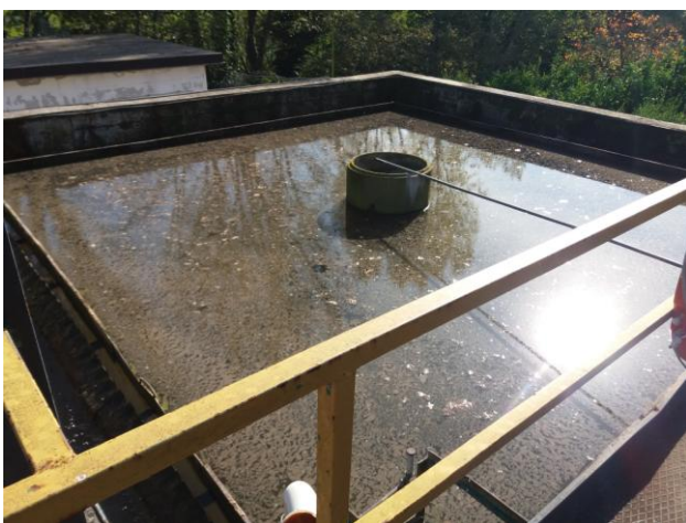
Vasca di sedimentazione
