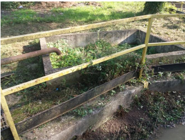
Vasca per disidratare la sabbia, non utilizzata
