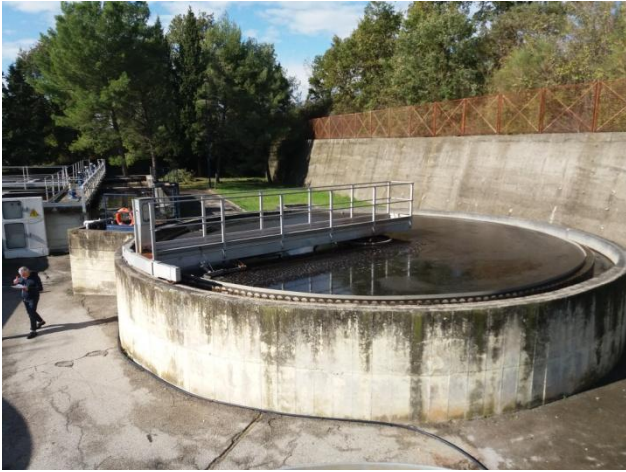
Vasca di sedimentazione primaria
