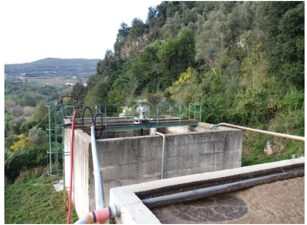
In fondo ispessitore/digestore aerobico utilizzato in anaerobiosi
