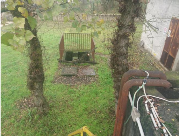
In fondo ingresso reflui e sollevamento
