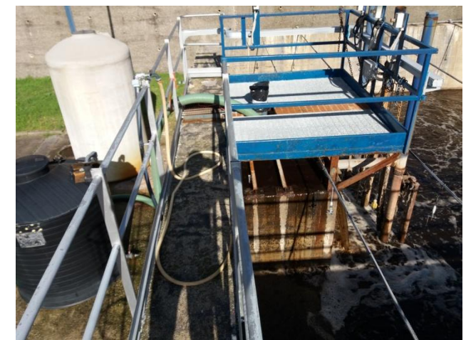
Silos e pozzetto di chiariflocculazione
