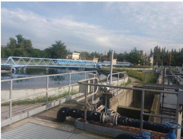
Vasca di sedimentazione secondaria
