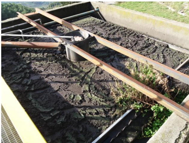
Vasca di sedimentazione
