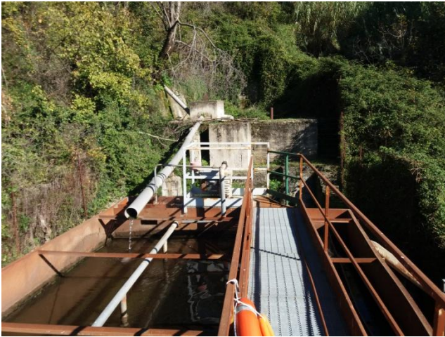
In alto a sinistra ultimo pozzetto della rete fognaria prima dell'ingresso all'impianto con sfioro
