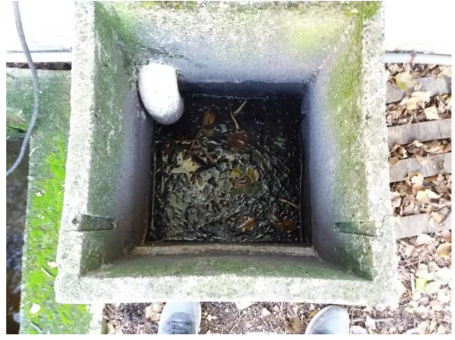
Pozzetto acque di drenaggio letti di essiccamento
