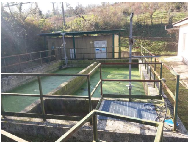
Vasche di predenitrificazione non funzionanti
