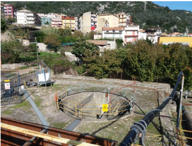
Ispessitore (vasca imhof)
