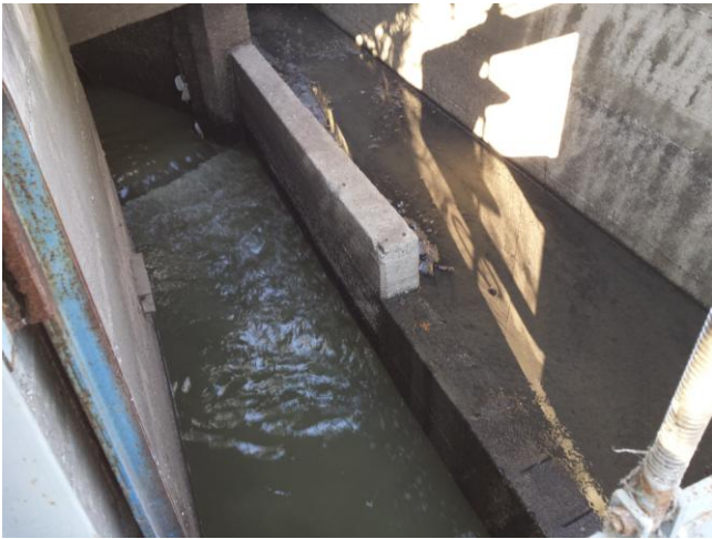
A destra ingresso reflui e a sinistra lo sfioro
