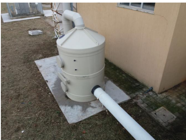
Filtro a carboni attivi, raccoglie l'aspirazione delle centrifughe e dello stripping
