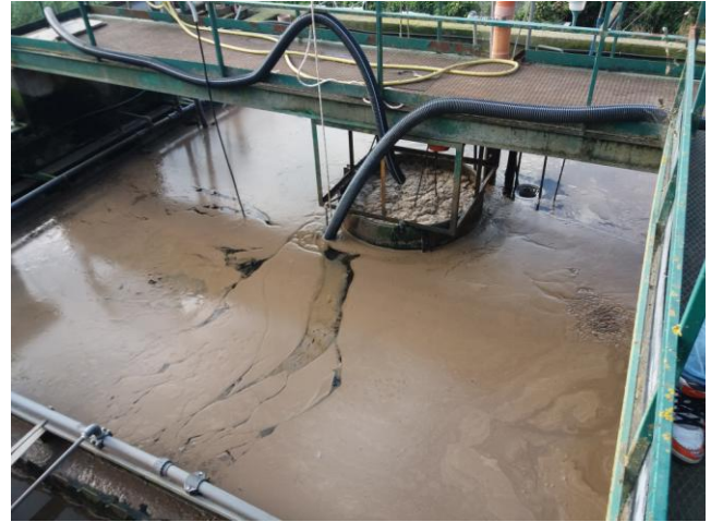
Vasca di sedimentazione. Non essendoci sistemi automatici l'asportazione dei fanghi superficiali avviene manualmente
