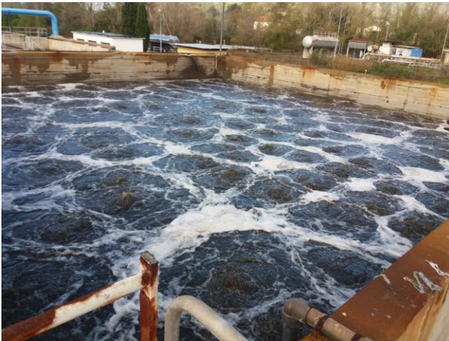
Vasca sx di stoccaggio e miscelazione rifiuti liquidi (D15)
