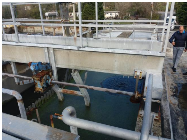
Disoleatura e dissabbiatura a ponte
