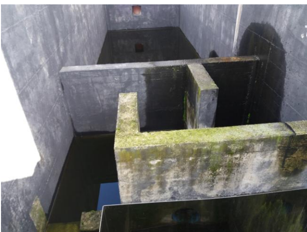
Vasca di disinfezione dei reflui destinati alla filtrazione in caso di avaria della condotta SNAM
