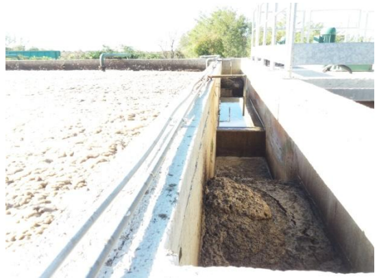
Figura 8. A sinistra l'MBBR 2° stadio. A destra lo stramazzo. Aggiunta flocculante.
