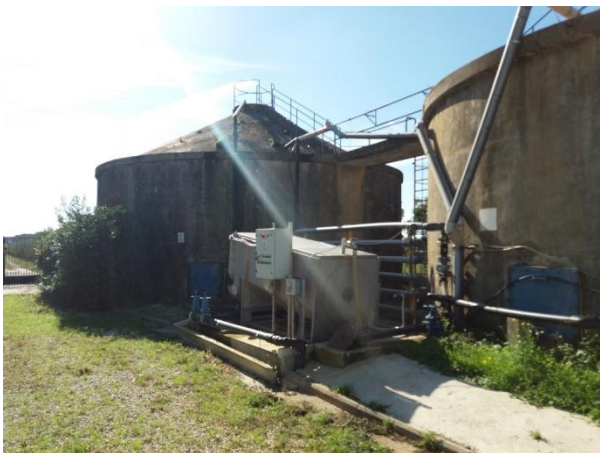
Figura 17. I digestori anaerobici. Davanti l'addensatore.
