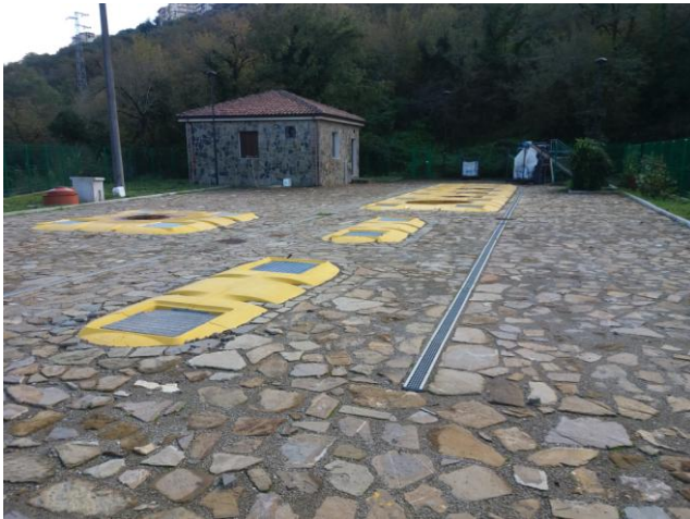
Vista impianto depurazione di Felitto. Tutte le fasi, eccetto grigliatura, rotostacciatura e dissabbiatura, sono eseguite in vasche a tenuta interrate
