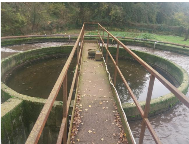
Vasca di sedimentazione
