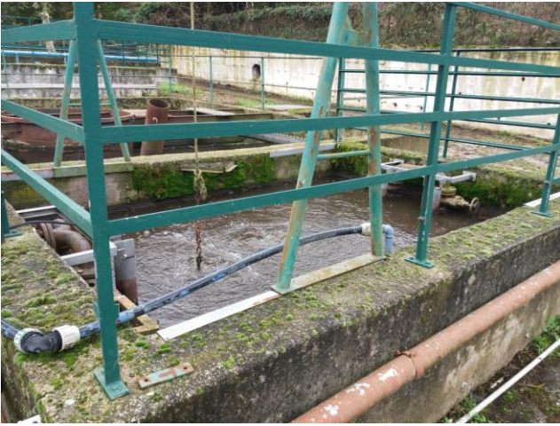
Pozzetto ricircolo fanghi
