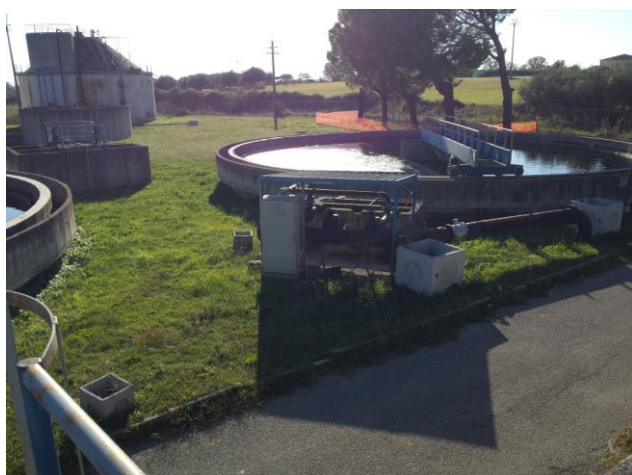
Vasca di sedimentazione primaria destra idraulica
