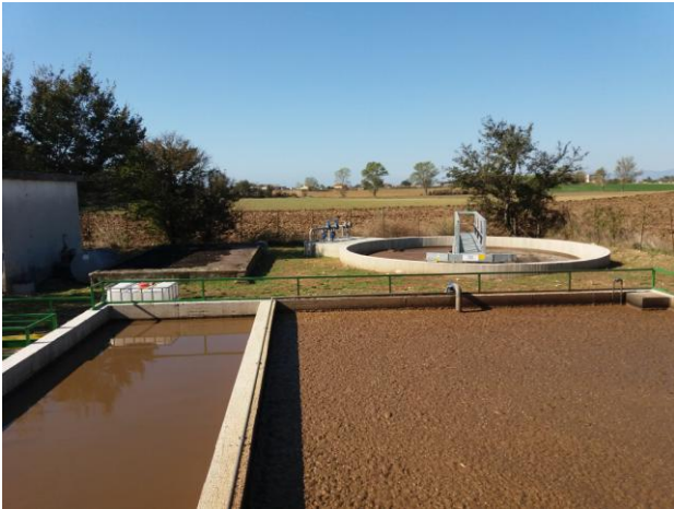
Sulla sinistra la vasca di predenitrificazione, mentre sulla destra la vasca di ossidazione. Sullo sfondo la vasca circolare di sedimentazione e disinfezione e alla sinistra i letti di essiccamento.
