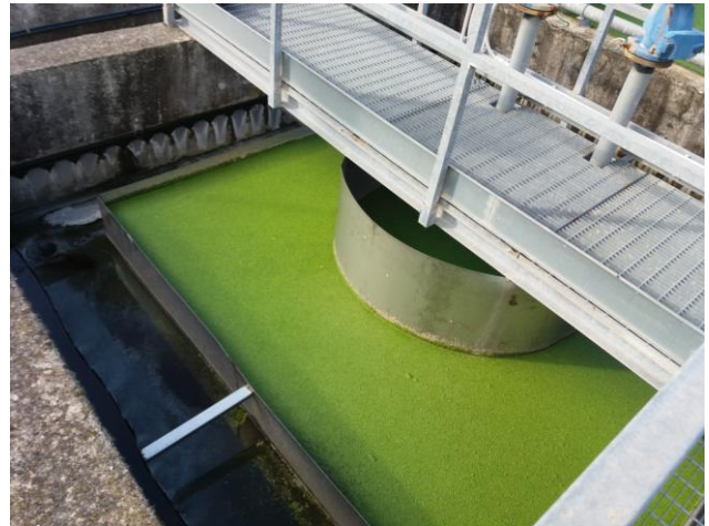
Vasca di sedimentazione
