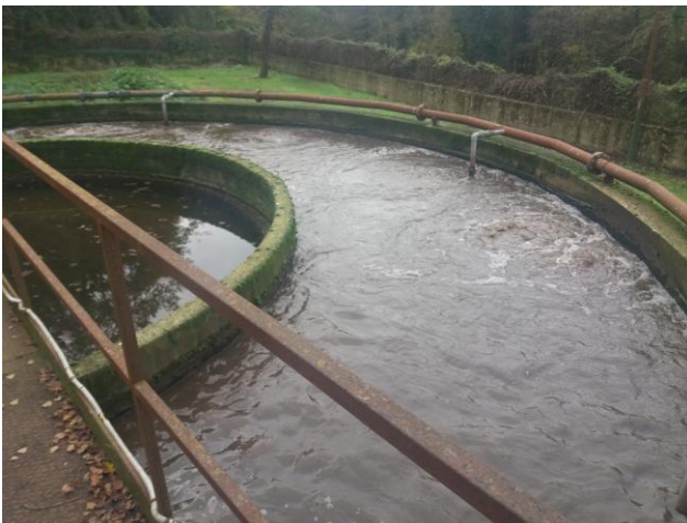
Vasca di ossidazione dettaglio lato destro
