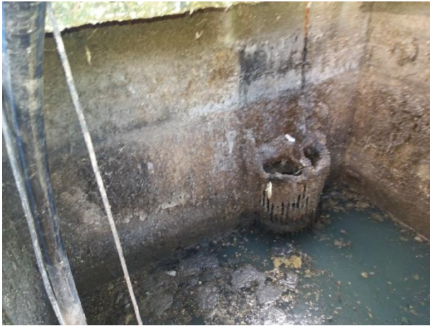
Ingresso reflui, grigliatura e sollevamento con sfioro
