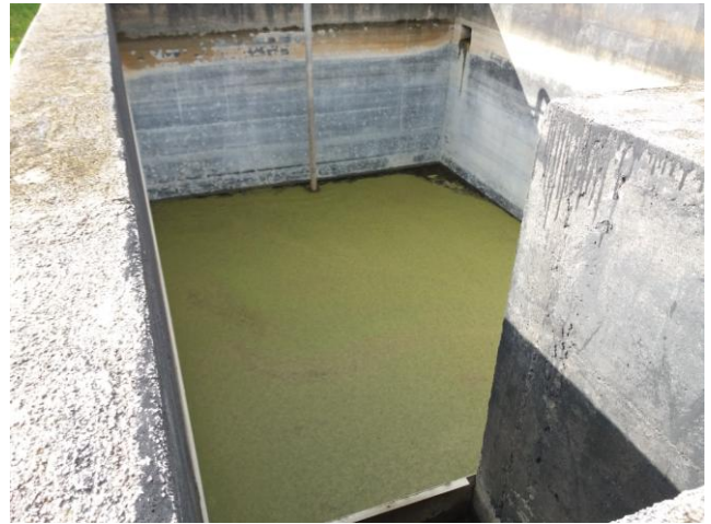
Unità di ossidazione lato destro non funzionante
