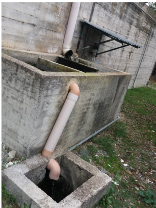
Pozzetto di carico nel Torrente La Cosa
