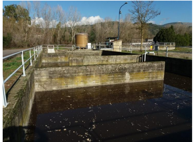
Vasca di disinfezione
