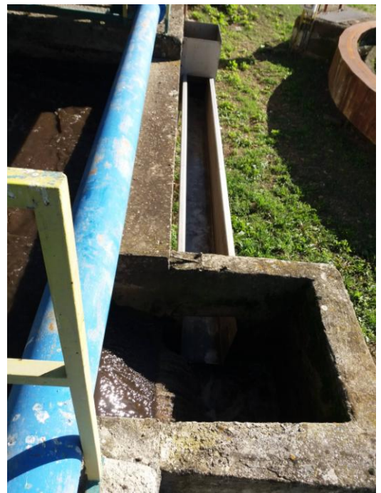
Passaggio alla sedimentazione
