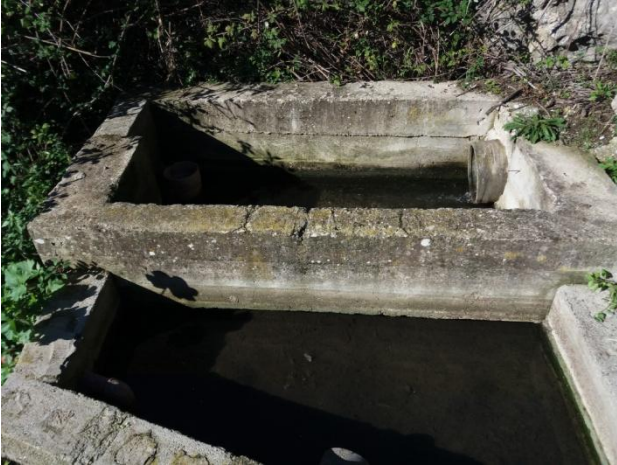
Ingresso liquami e sfioro
