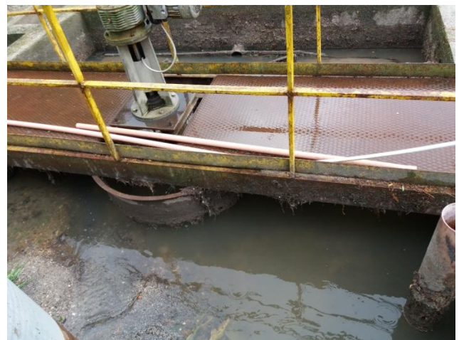
Dettaglio vasca di sedimentazione primaria
