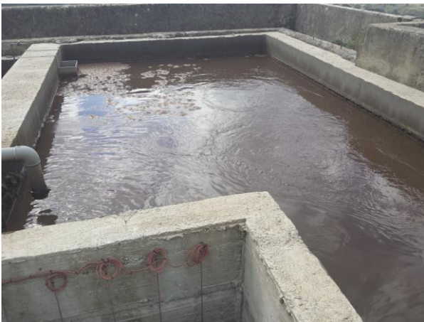
Vasca di predenitrificazione
