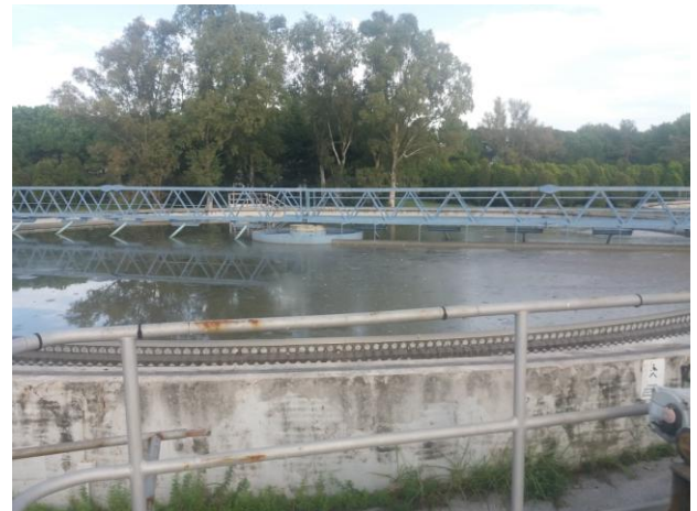
Dettaglio vasca sedimentazione primaria
