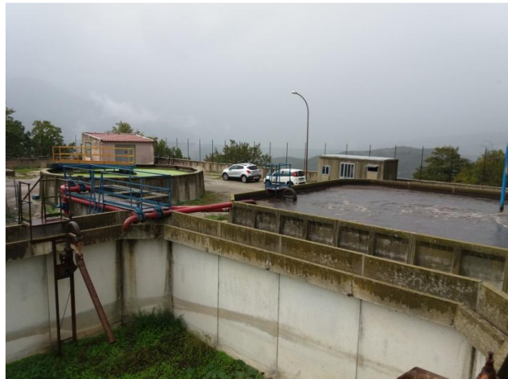
A destra la vasca di ossidazione, mentre in fondo la vasca di sedimentazione.
