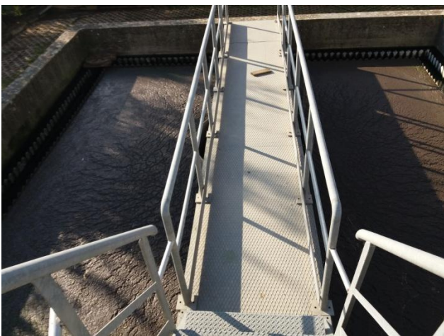
Vasca di sedimentazione secondaria
