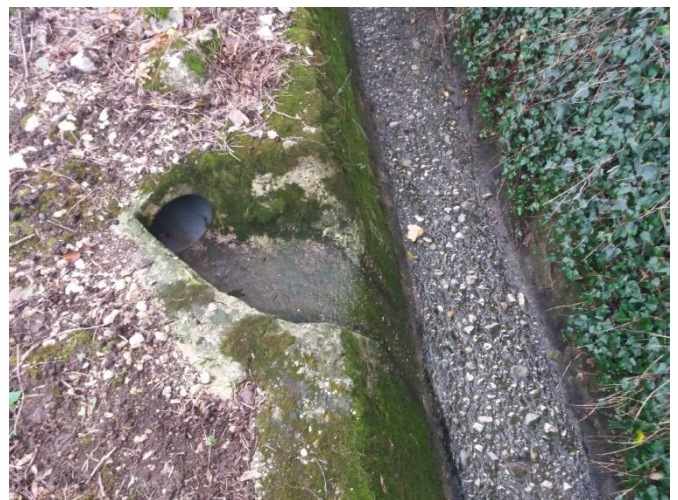
Scarico dello sfioro del depuratore
