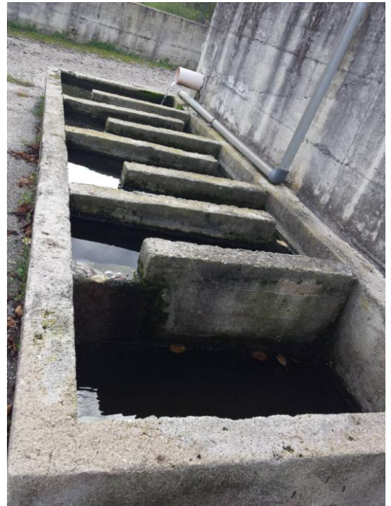
Vasca di disinfezione
