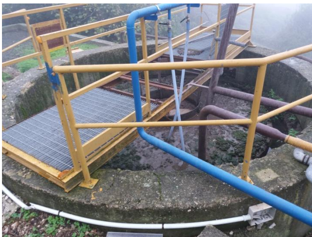
Vasca di sedimentazione
