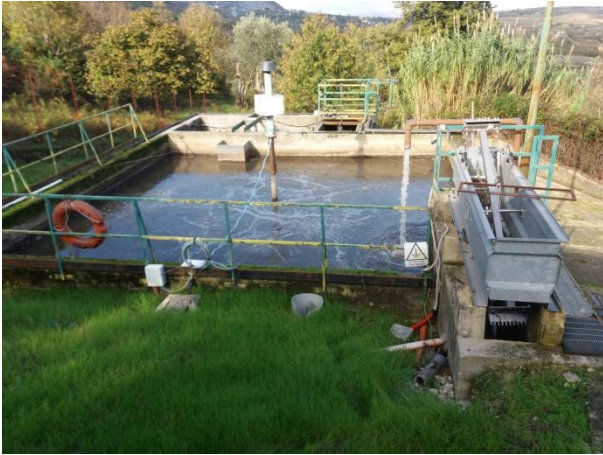
Impianto di depurazione
