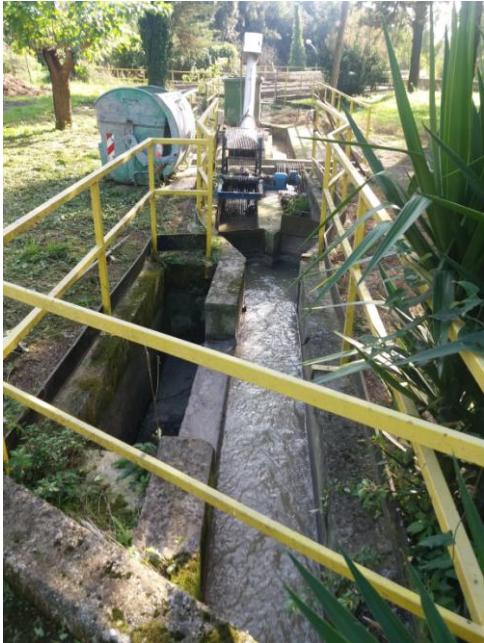
Ingresso reflui. Alla sinistra lo sfioro ed in fondo la grigliatura automatica
