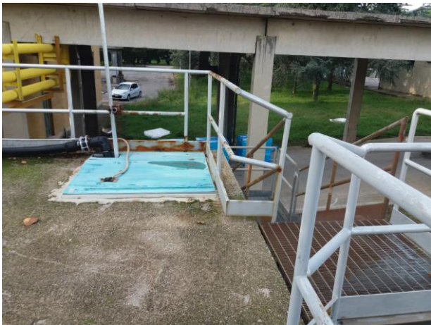
Dettaglio vasca di stripping
