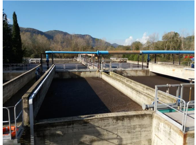
Davanti le vasche di denitrificazione. In fondo le vasche di ossidazione-nitrificazione
