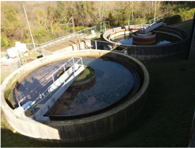
Davanti i due sedimentatori (a destra non funzionante), alle spalle il pozzetto di ricircolo
