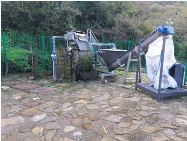
Rotostacciatura e dissabbiatura con selettore.
