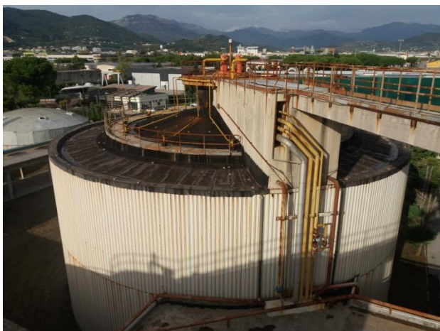
Dettaglio di un digestore anaerobico.
