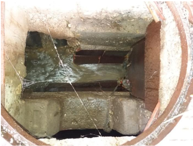
Ultimo pozzetto della rete fognaria con sfioro al vallone mastro pietra e ingresso al depuratore.
