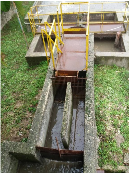
Canale di ingresso dei reflui con grigliaura manuale e vasca di sedimentazione primaria
