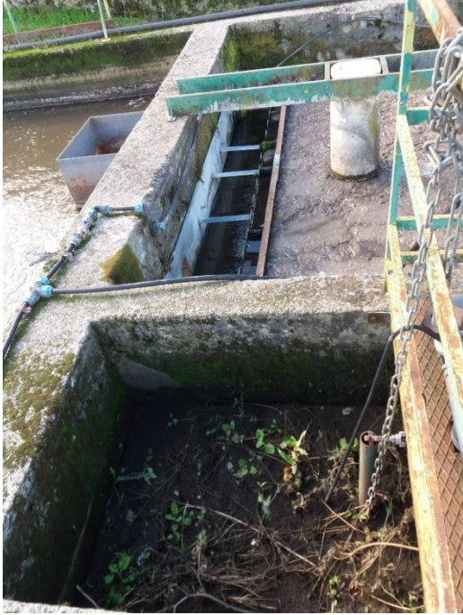
Pozzetto ricircolo fanghi
