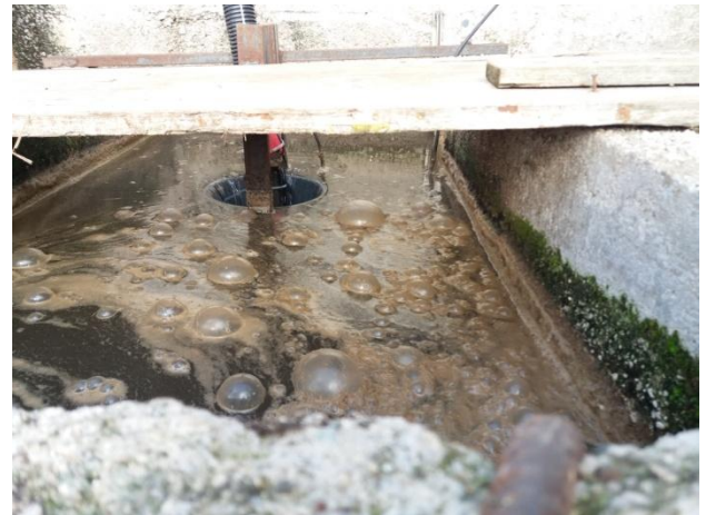
Dettaglio della disinfezione. Una pompa elimina eventuali schiume in superficie e li rimanda alla sedimentazione
