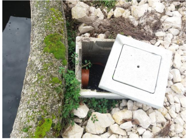
Pozzetto di uscita acque trattate
